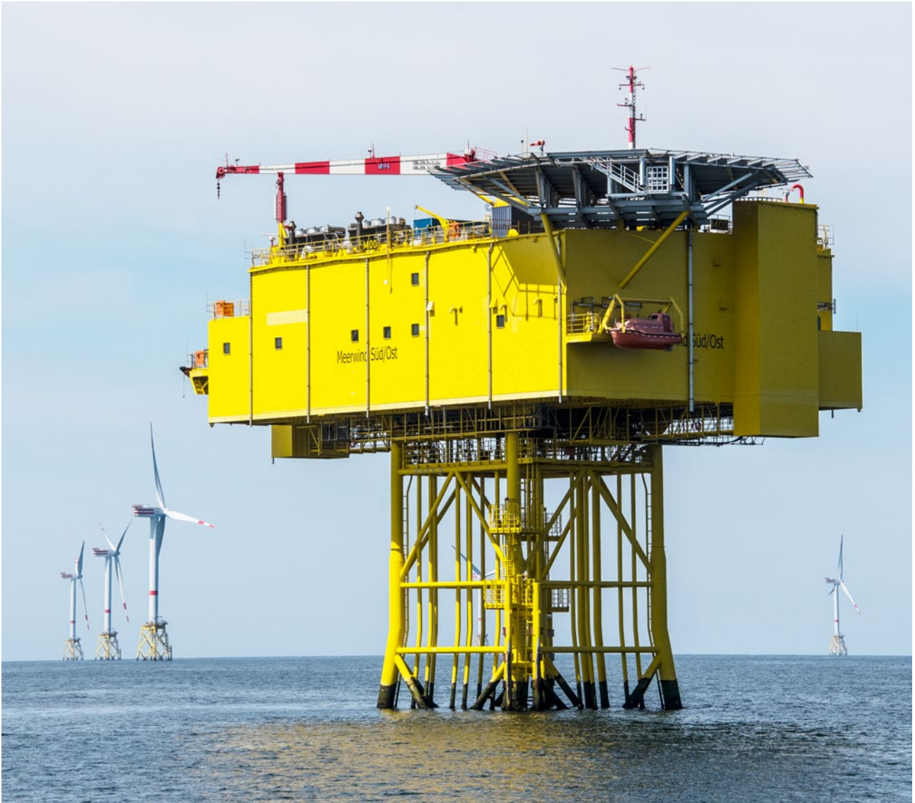
Offshore substation Windpark Meerwind Süd/Ost
