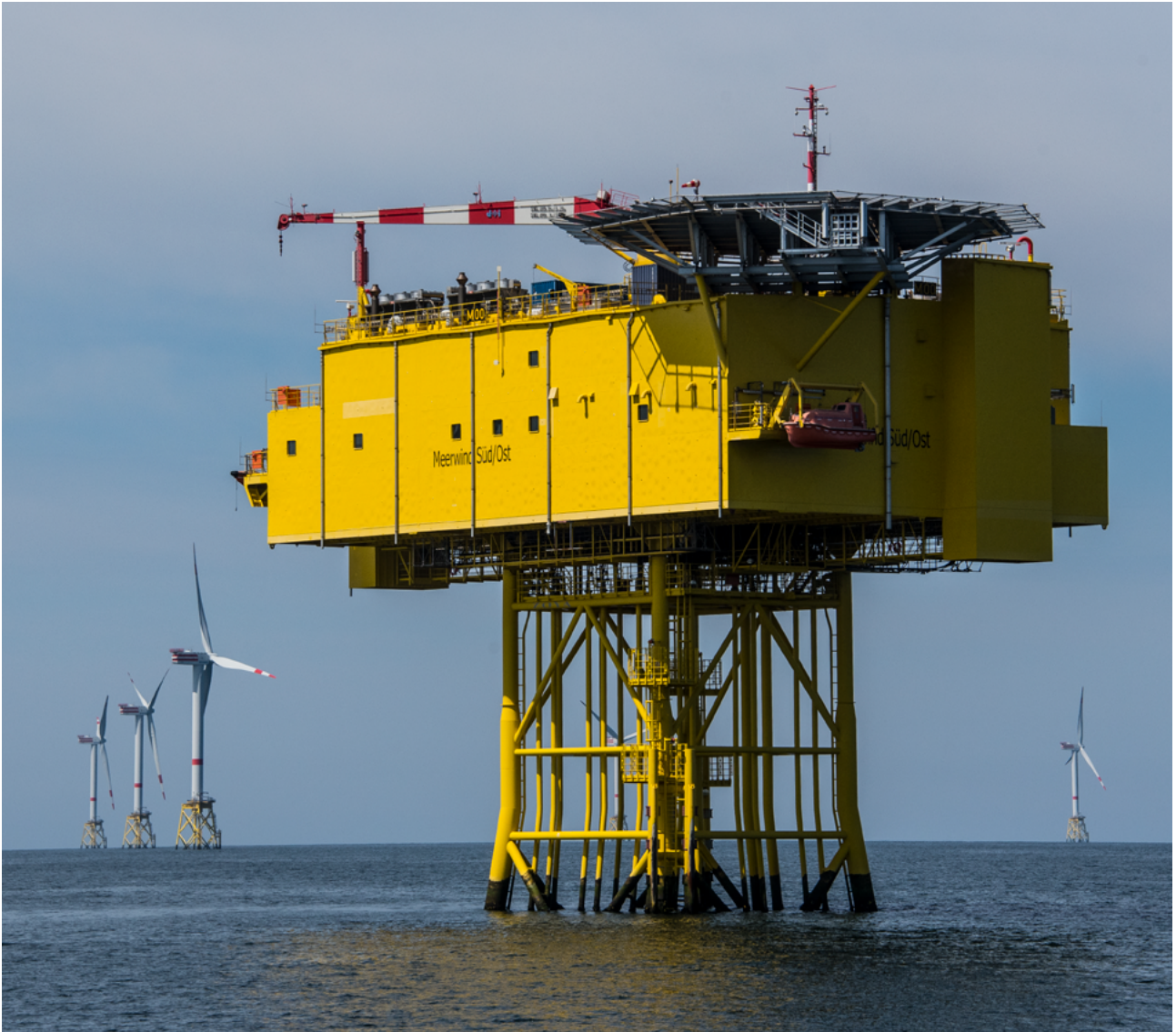
Umspannplattform Windpark Meerwind Süd/Ost
