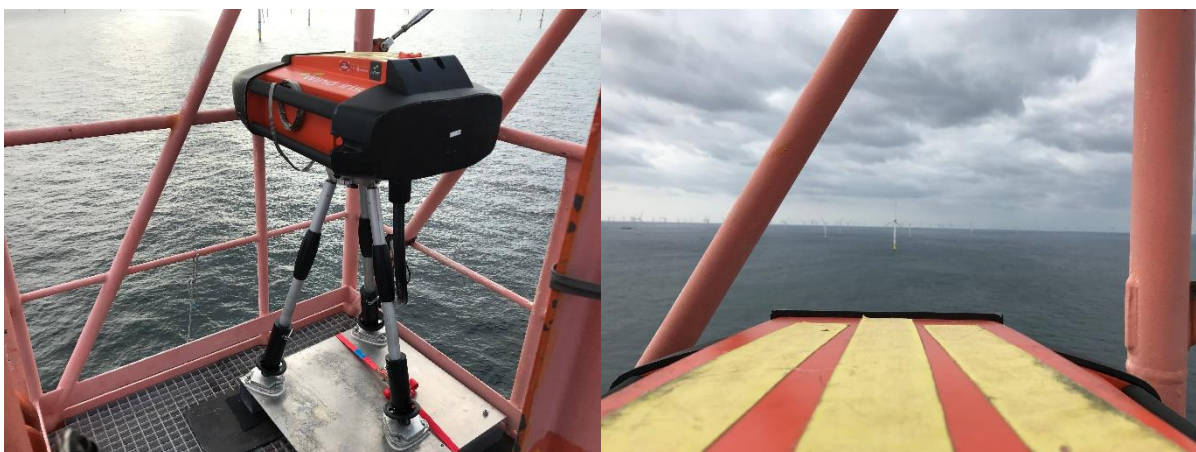
Abbildung 7-1: 2-Strahl Lidar auf der 87.5m Ebene installiert, links: Blick auf das Gerät, rechts: Blick vom Gerät auf eine Turbine vom Windpark Merkur in ca. 1500m Entfernung.
